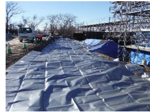
盛土箇所 除雪シート保護状況
