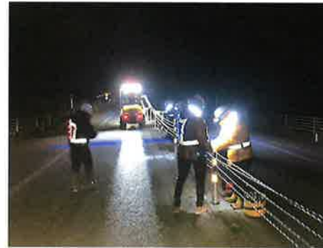
ワイヤロープ式防護柵設置状況
